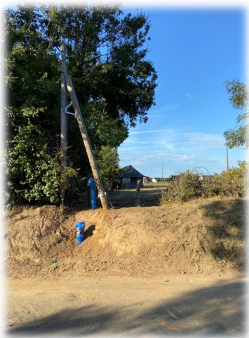
Poteau de citerne enterrée
